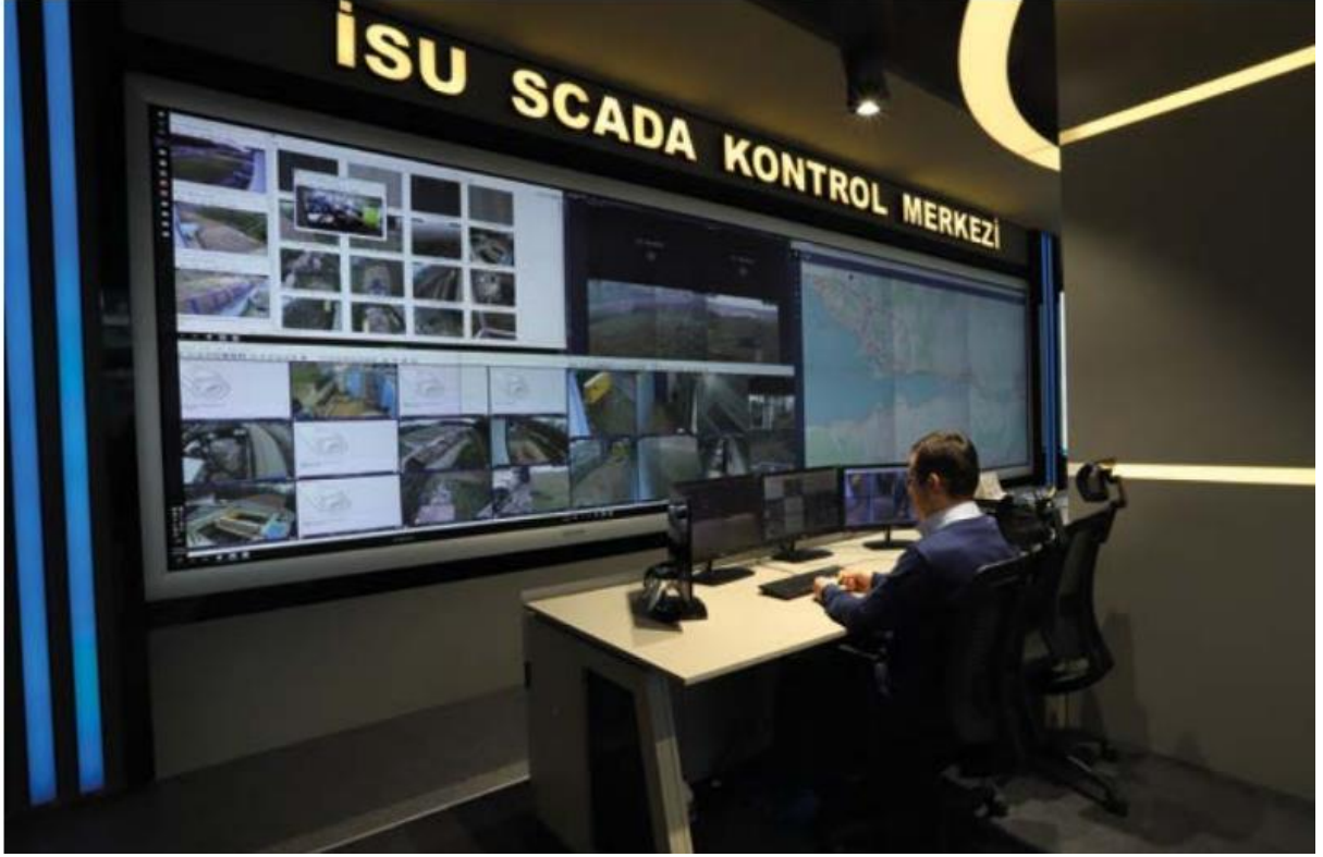
Şekil 7. Kocaeli Belediyesi SCADA Sistemi [11]
